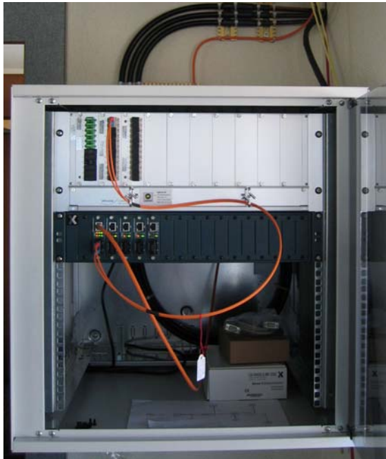
Singlemode Fast Ethernet-Verteiler bei Sternegg Tal
