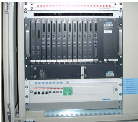
ORION™ Knoten mit redundanter Speisung
