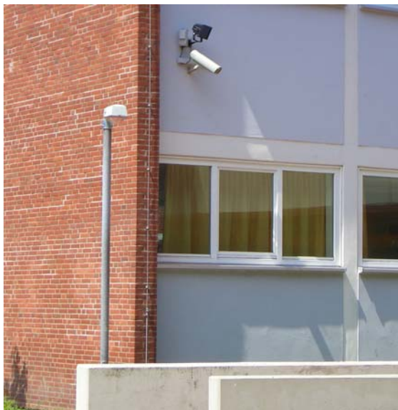
Gut sichtbare Überwachungskamera an einem der Schulhäuser
